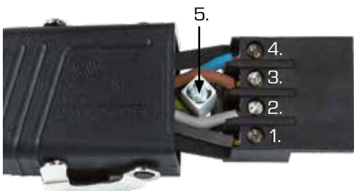
Kabelbelegung Motorseitig (STAS 4)
