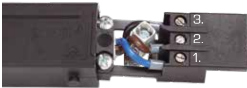
Kabelbelegung Motorseitig (STAS 3)
