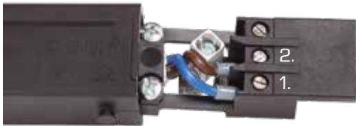
Kabelbelegung Motorseitig (STAS 3)
